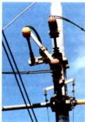
Figura 11: Commutatore in posizione di aperto con collegamento a terra della linea
