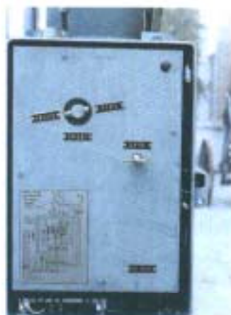
Figura 5: Interno argano a manovra elettrica con chiave a "T" inserita nell'apposita serratura
