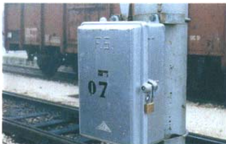
Figura 3: Argano a manovra elettrica
