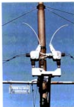
Figura 8: Sezionatore in posizione di chiuso
