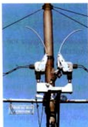
Figura 7: Sezionatore in posizione di aperto
