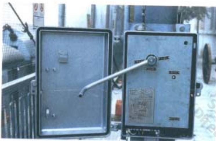
Figura 6: Interno argano a manovra elettrica con leva a ginocchio innestata nel perno di manovra
