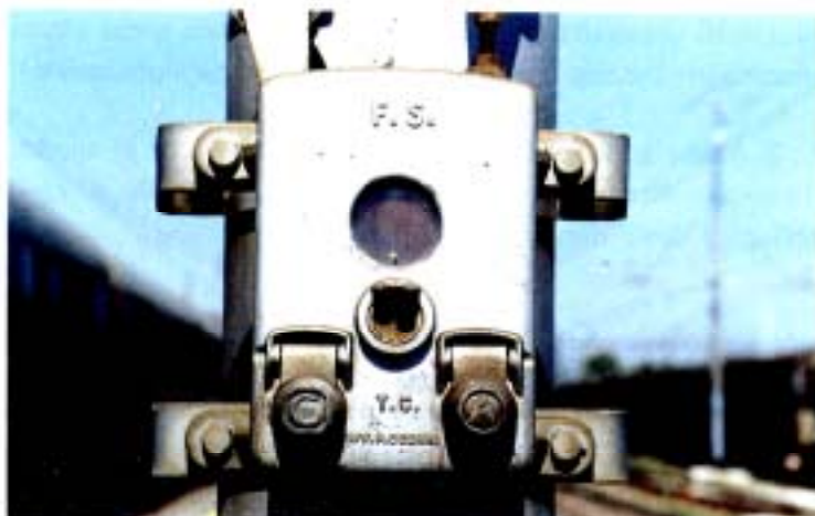
Figura 9: Argano di manovra dei commutatori
