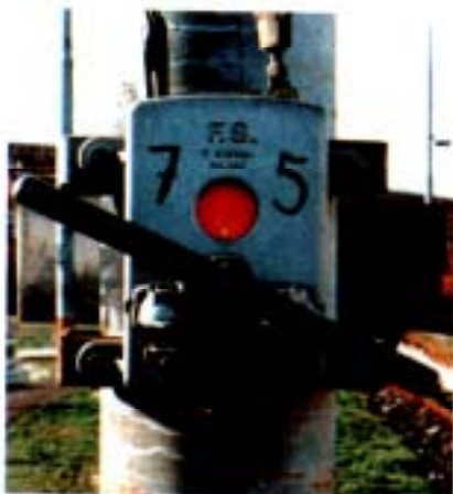
Figura 12: Argano in posizione di chiuso
